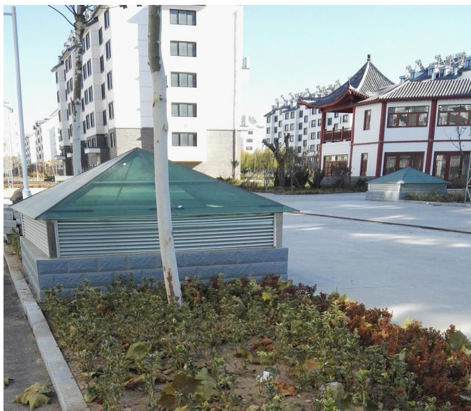
图 10-1 地下车库通风井
